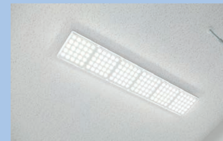
LED照明の積極導入
