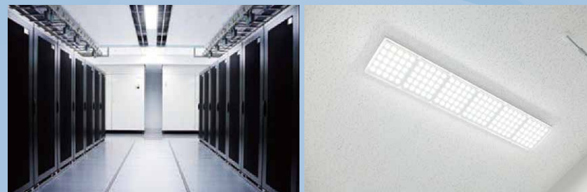
きめ細かく空調制御されたサーバールーム
