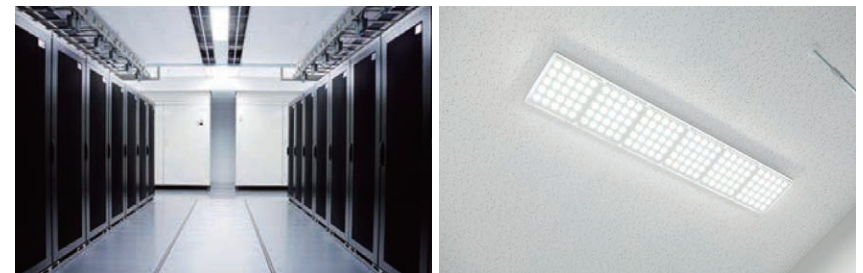
きめ細かく空調制御されたサーバールーム
