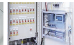
サーバラック電力監視
